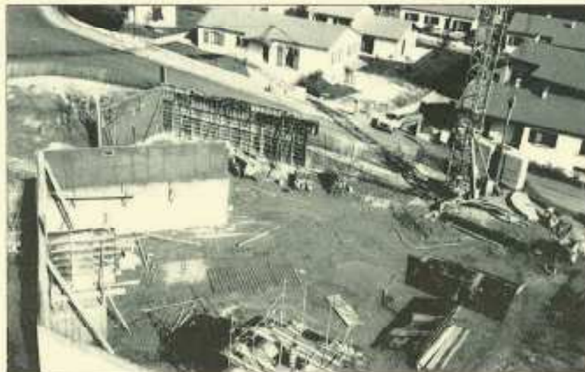
Construction d'un bâtiment communal (garages municipaux, dépôt à sel, cantine scolaire et salles).
